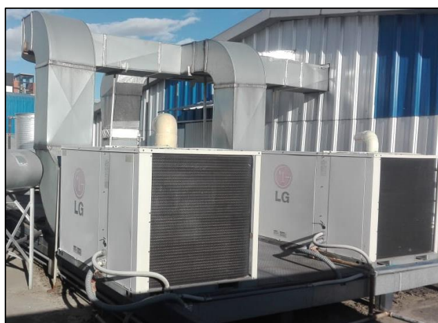
Figura 5: Unidades Manejadoras de aire (UMA) de la bodega de almacenamiento
