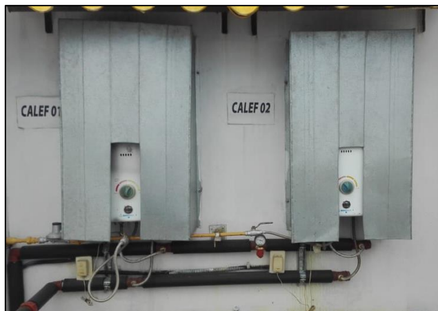
Figura 4: Calefones del sistema de ventilación
