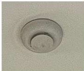
Figura 9. Detector de incendios automático.
