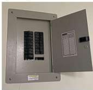
Figura 7. Caja de breakers
