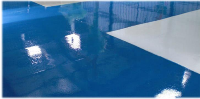
Imagen 6: Piso epóxico (permeable) Fuente: Inpra, pintura y recubrimiento profesional
