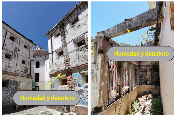
Figura 24. Mal estado técnico Inmueble Ex Penal García Moreno
