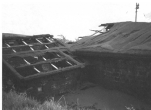
Figura 7. Afectaciones provocadas por acumulación de ceniza volcánica proveniente del volcán Tungurahua con un espesor de 7cm acumulados en las cubiertas
