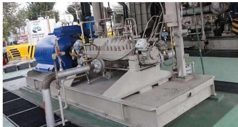
Figura 54: Grupo de bombeo eléctrico.
