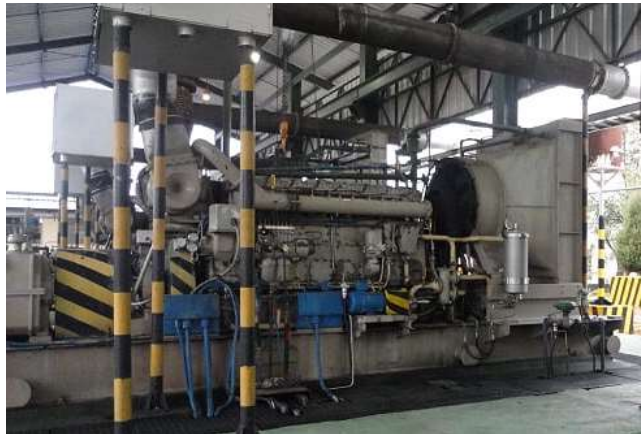
Figura 49: Grupos de bombeo de diésel.
