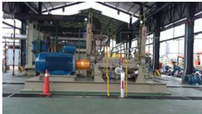
Figura 15: Grupo de bombeo eléctrico
