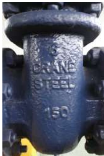
Figura 47: Válvula bomba booster
