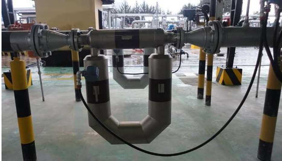
Figura 48: Medidor másico tipo coriolis
