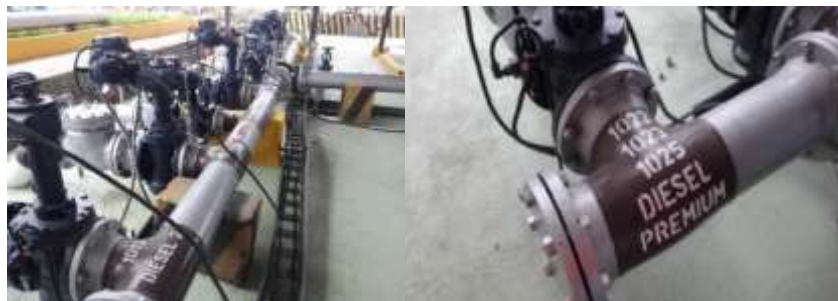
Figura 9: Manifold de válvulas
