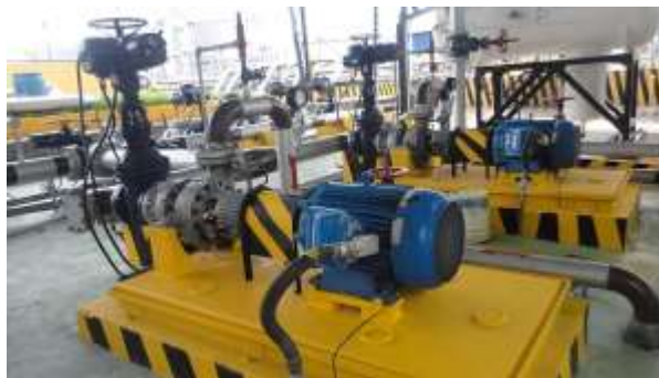
Figura 46: Motor y bomba booster
