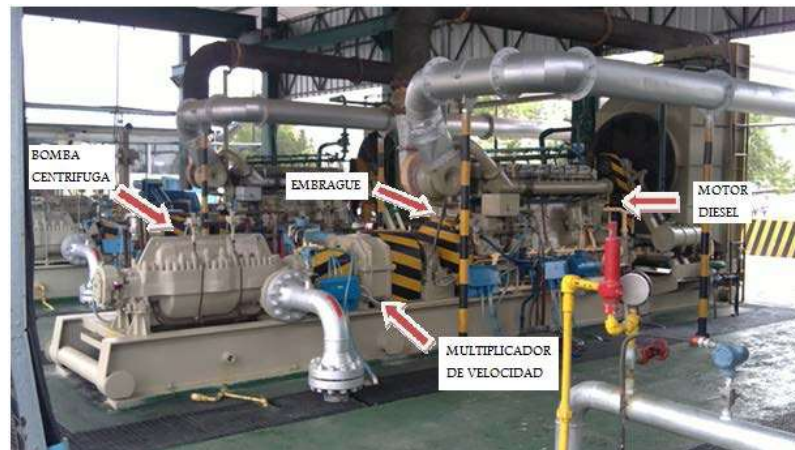
Figura 14: Grupo de Bombeo a Diésel
