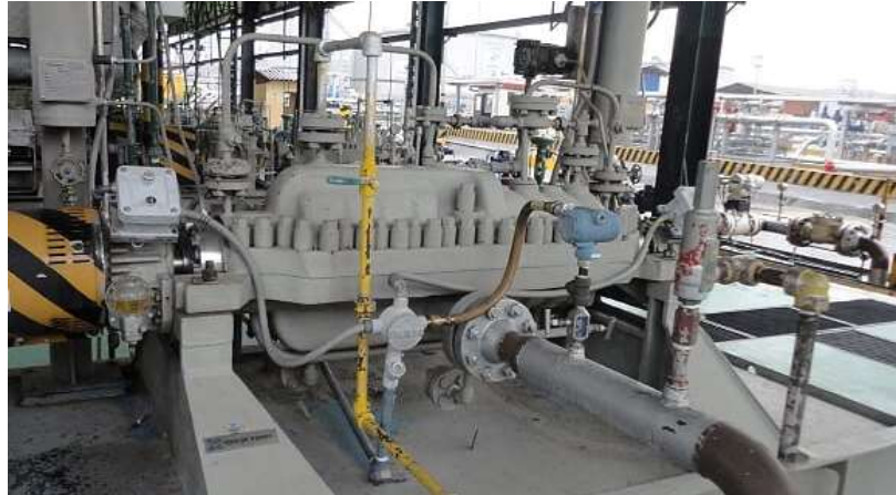
Figura 56: Bomba del grupo de bombeo eléctrico.
