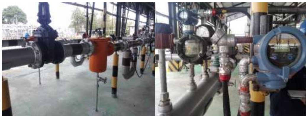
Figura 12: Medidor Másico tipo Coriolis
