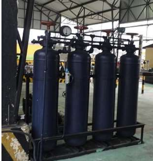
Figura 58: Tanques de almacenamiento de aire.
