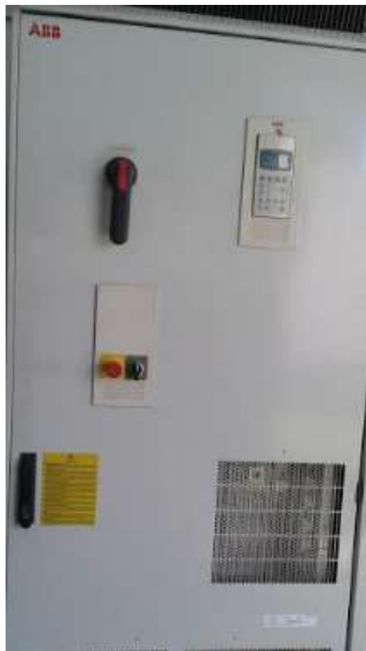
Figura 86: Centro de control de variador de velocidad
