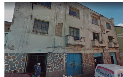
Vivienda en abandono
