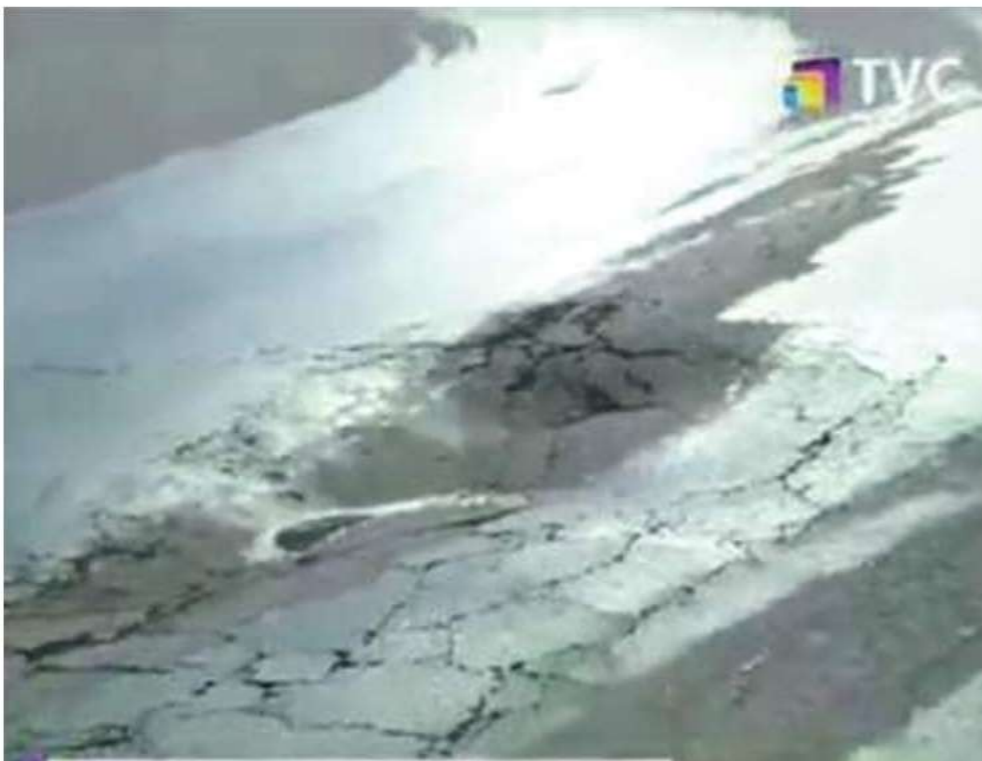
Hundimiento de vía por fuga de Agua, La Argelia (2018)
