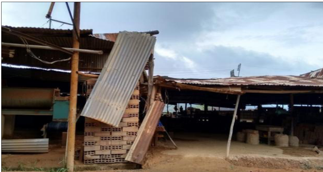
Imagen 16: Techos en mal estado
