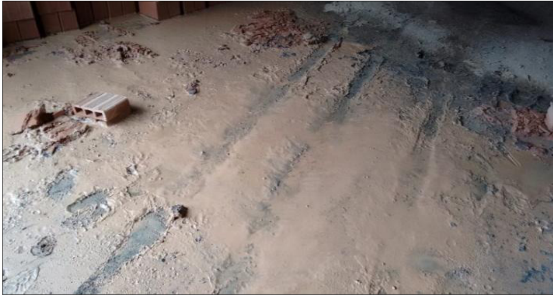
Imagen 21: Barro ocasionado por agua.
