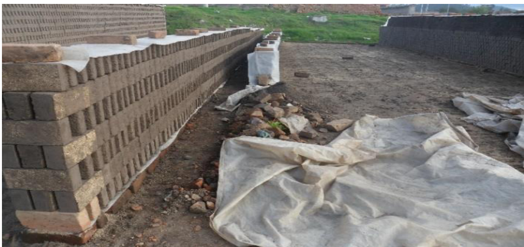
Imagen 18: Desperdicios en pasillos.
