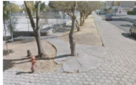
Mal estado de aceras
