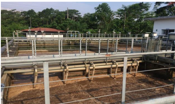
Tanque de homogenización de la Planta de Tratamiento Terere
