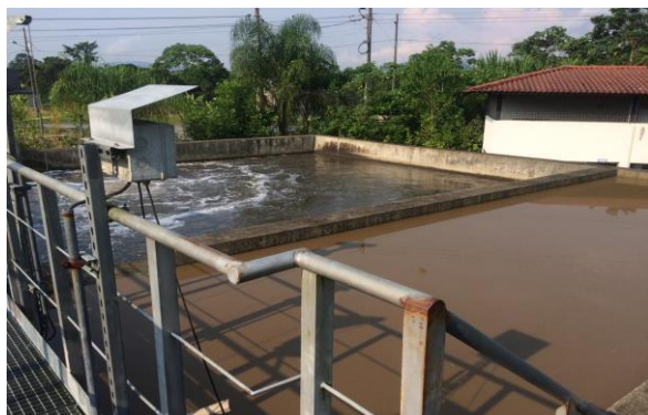
Tanque de aeración
