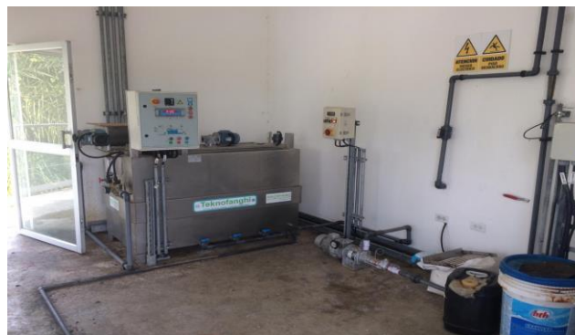
Cuarto de máquinas
