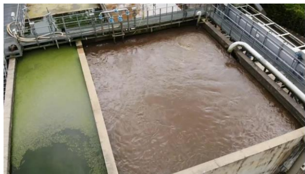
Tanque de floculación
