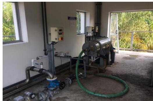
Cuarto de máquinas
