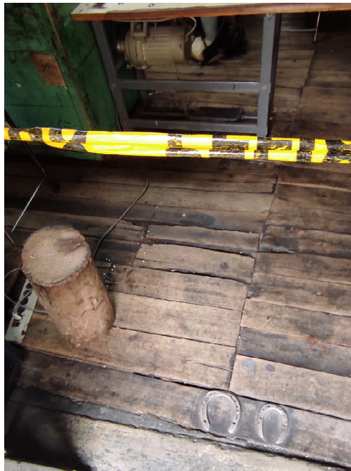
Imagen 85: Deformación en elementos de acabados.
