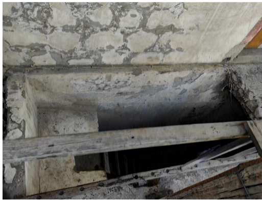
Imagen 76: Humedad en elementos de acabados.
