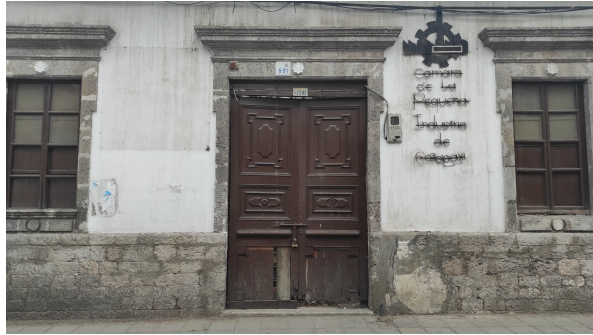
Imagen 43: Patrimonio edificado deteriorado.
