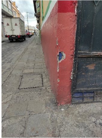
Imagen 24: Desprendimiento en inmueble patrimonial de latacunga.
