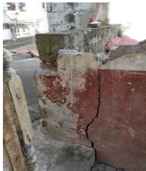
Imagen 96: Grietas en elementos de estructura.
