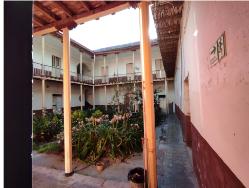
Imagen 58: Patologías en inmueble patrimonial.
