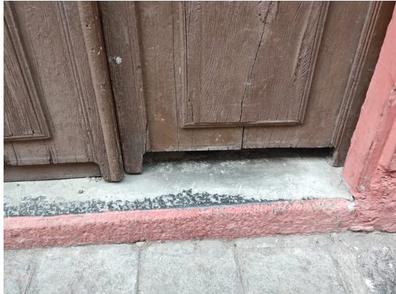
Imagen 22: Fisuras en vivienda patrimonial.
