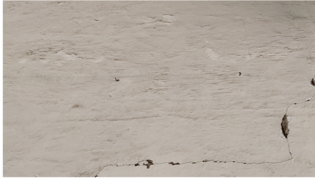
Imagen 97: Grietas en elementos estructurales.
