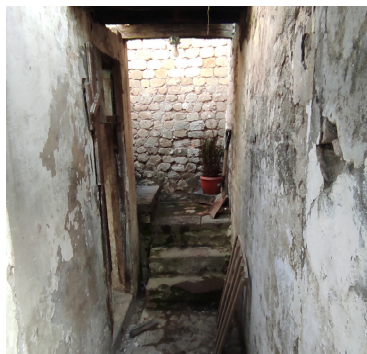
Imagen 78: Erosión física en elementos de estructura.
