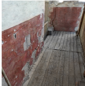
Imagen 91: Desprendimientos en elementos de acabados.
