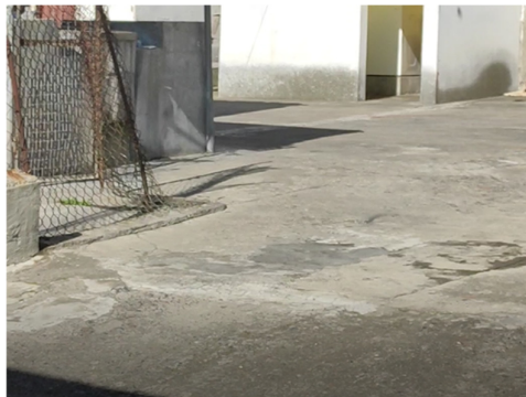
Imagen 73: Erosión química en elementos de acabados.
