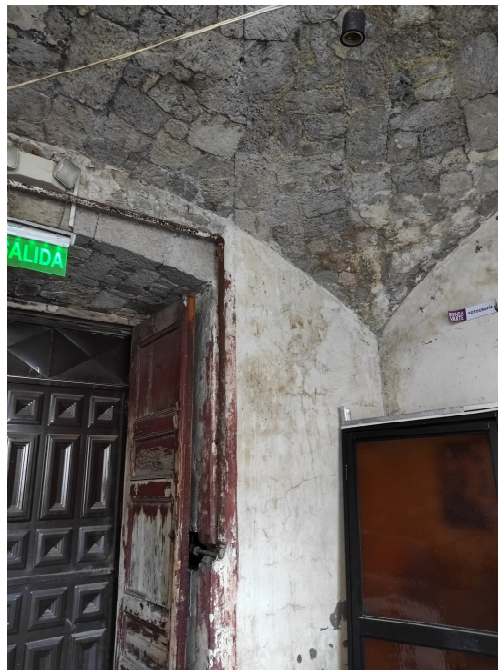
Imagen 36: Patologías en el centro histórico de Latacunga.
