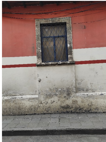
Imagen 17: Humedad en fachada de vivienda patrimonial.
