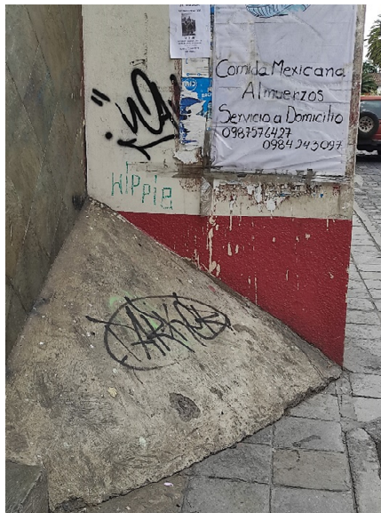
Imagen 27: vandalismo en inmueble patrimonial comercial.
