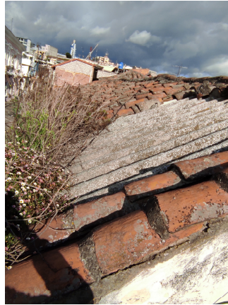
Imagen 69: Organismos en elementos estructurales.
