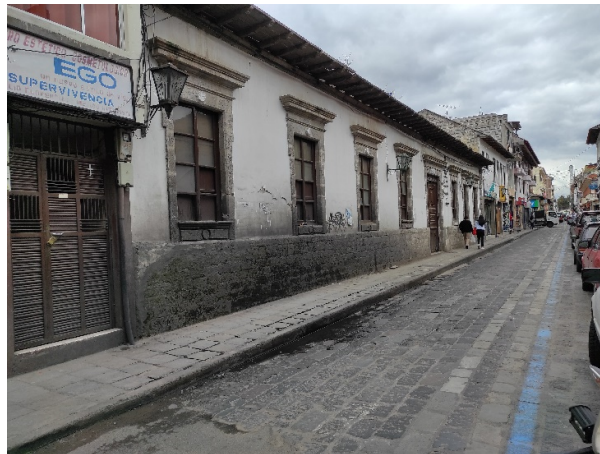
Imagen 11: Afectaciones en fachada provocadas por el smog de automóviles calle Belisario Quevedo.
