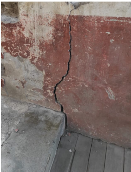
Imagen 23: Grietas en vivienda patrimonial.
