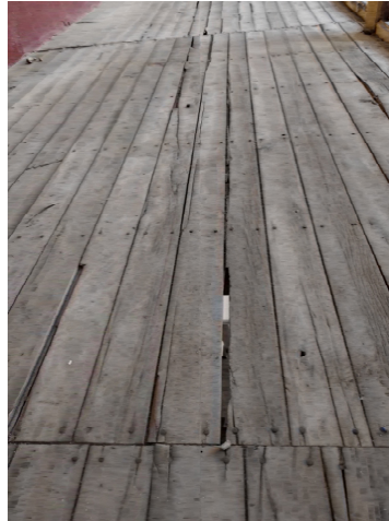
Imagen 88: Fisuras en pisos de madera.
