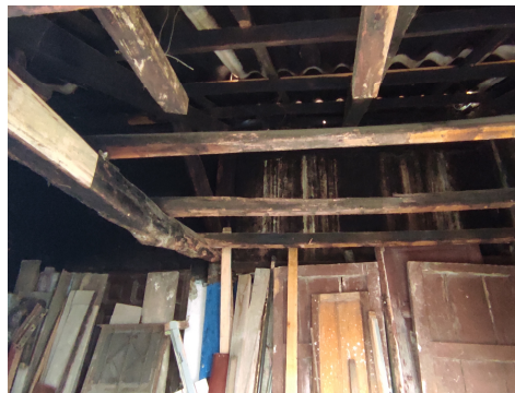
Imagen 84: Deformación en elementos de estructura.
