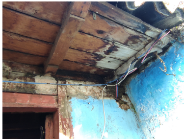
Imagen 75: Humedad en elementos de estructura.
