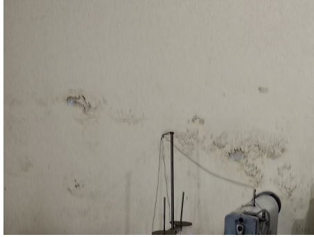
Imagen 63: Afectación por eflorescencia sobre elementos acabados.
