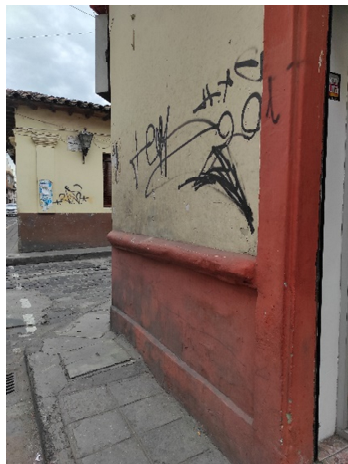
Imagen 21: Suciedad en fachada vivienda patrimonial.
