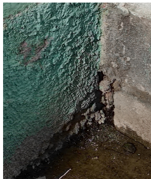
Imagen 72: Erosión química en elementos de estructura.
