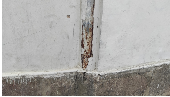
Imagen 67: Corrosión en elemento de acabado.
