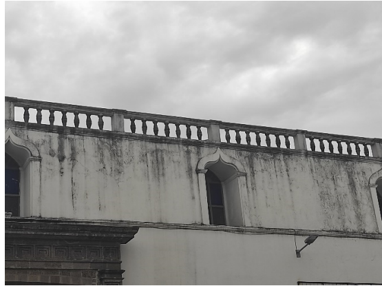
Imagen 20: Suciedad en fachada de la iglesia La Catedral de Latacunga.
