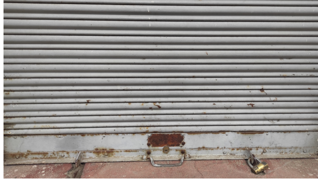
Imagen 65: Oxidación en elemento de acabado.
