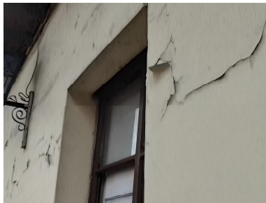
Imagen 87: Fisuras en elementos de acabados.
