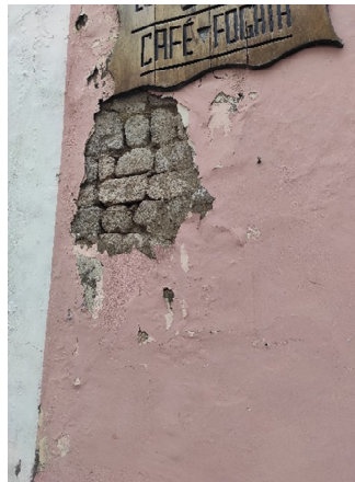
Imagen 25: Desprendimiento en inmueble patrimonial comercial de latacunga.
