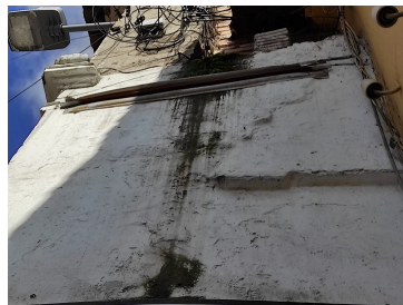
Imagen 81: Suciedad en elementos estructurales.
