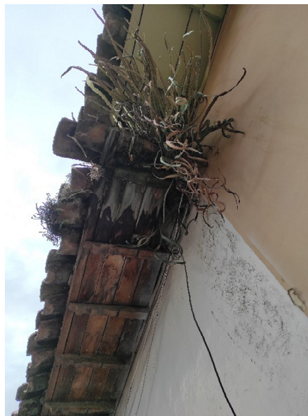
Imagen 29: Presencia de organismos en vivienda patrimonial.
