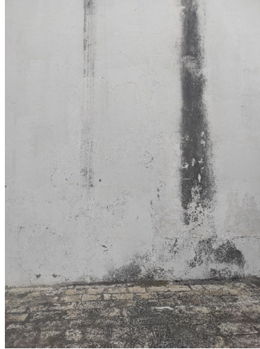
Imagen 16: Humedad en fachada.
