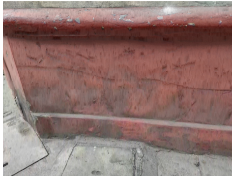
Imagen 82: Suciedad en elementos de acabados.
