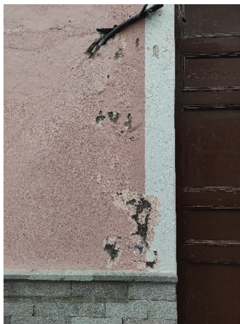
Imagen 19: Erosión en fachada de vivienda patrimonial.
