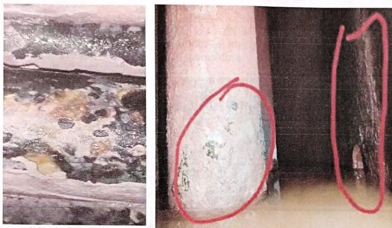
Fotos referenciales tubos con corrosión
