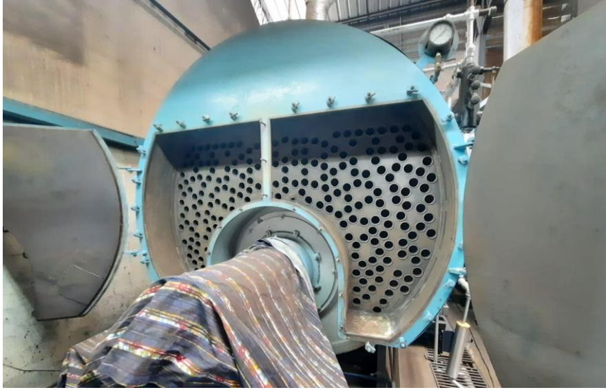
Imagen 23 Puertas y refractario aislante limpio del caldero
