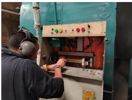
Imagen 30 Tablero de control del caldero
