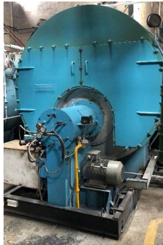
Imagen 3 Caldero de vapor Kewanee 500 bhp Fuente: Edison Espinoza.
