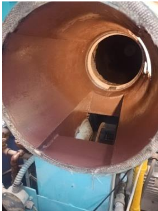
Imagen 29 Limpieza del hogar del caldero Fuente: Edison Espinoza
