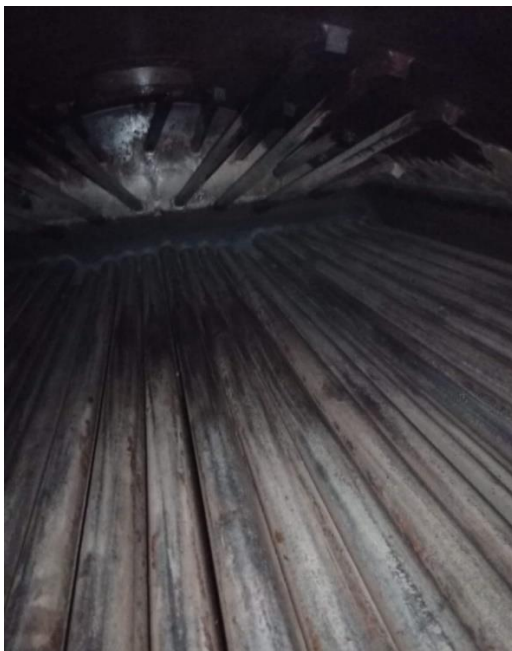
Imagen 31 Tubos de fuego con tratamiento químico
