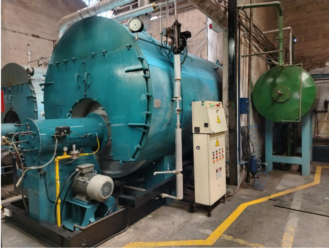
Imagen 35 Caldero de 500 bhp repotenciado
