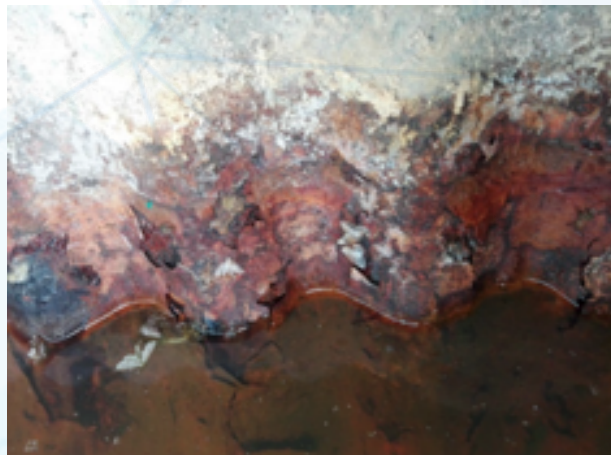
Figura 4. Deterioro actual de los tanques de preservado
