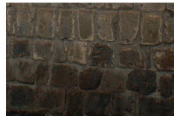
⑥ PATOLOGÍA Humedad en la piedra Pishilata
