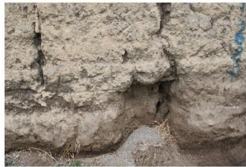
⑤ PATOLOGÍA Fractura de las paredes
