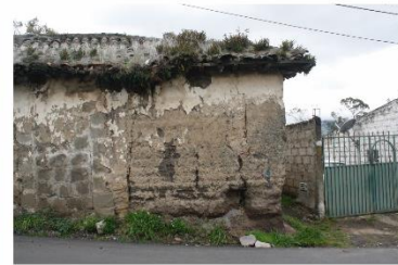
⑥ PATOLOGÍA Crecimiento de plantas en cubierta y borde inferior (paredes)
