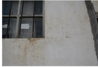
Barros de acero añadidos a las ventanas
