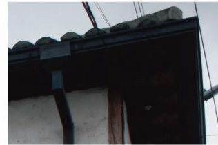
Canaleta y bajante de agua metálicos
