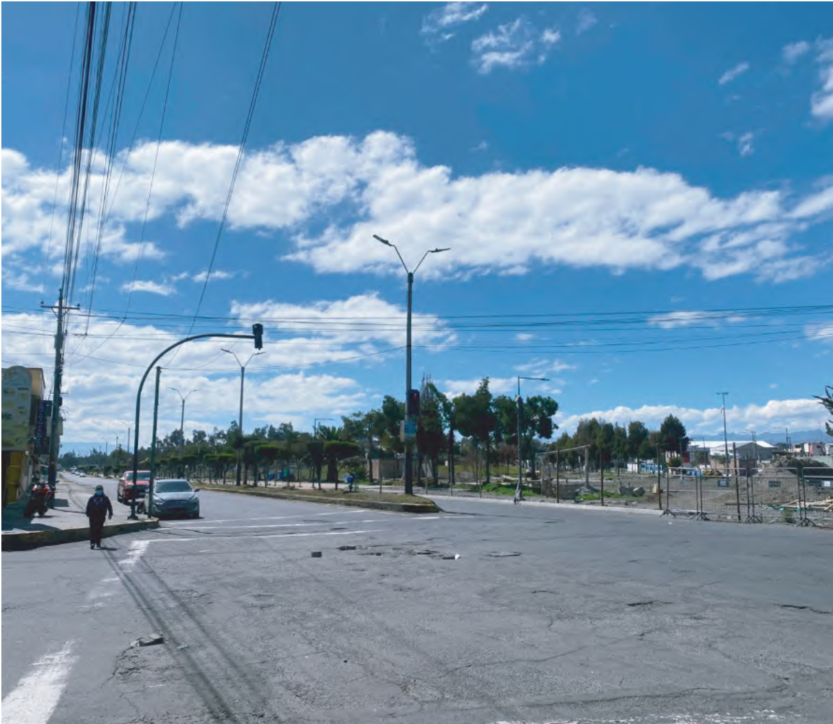
Figura 43. Vía Saquisilí, tramo uno, en mal estado - Antes
