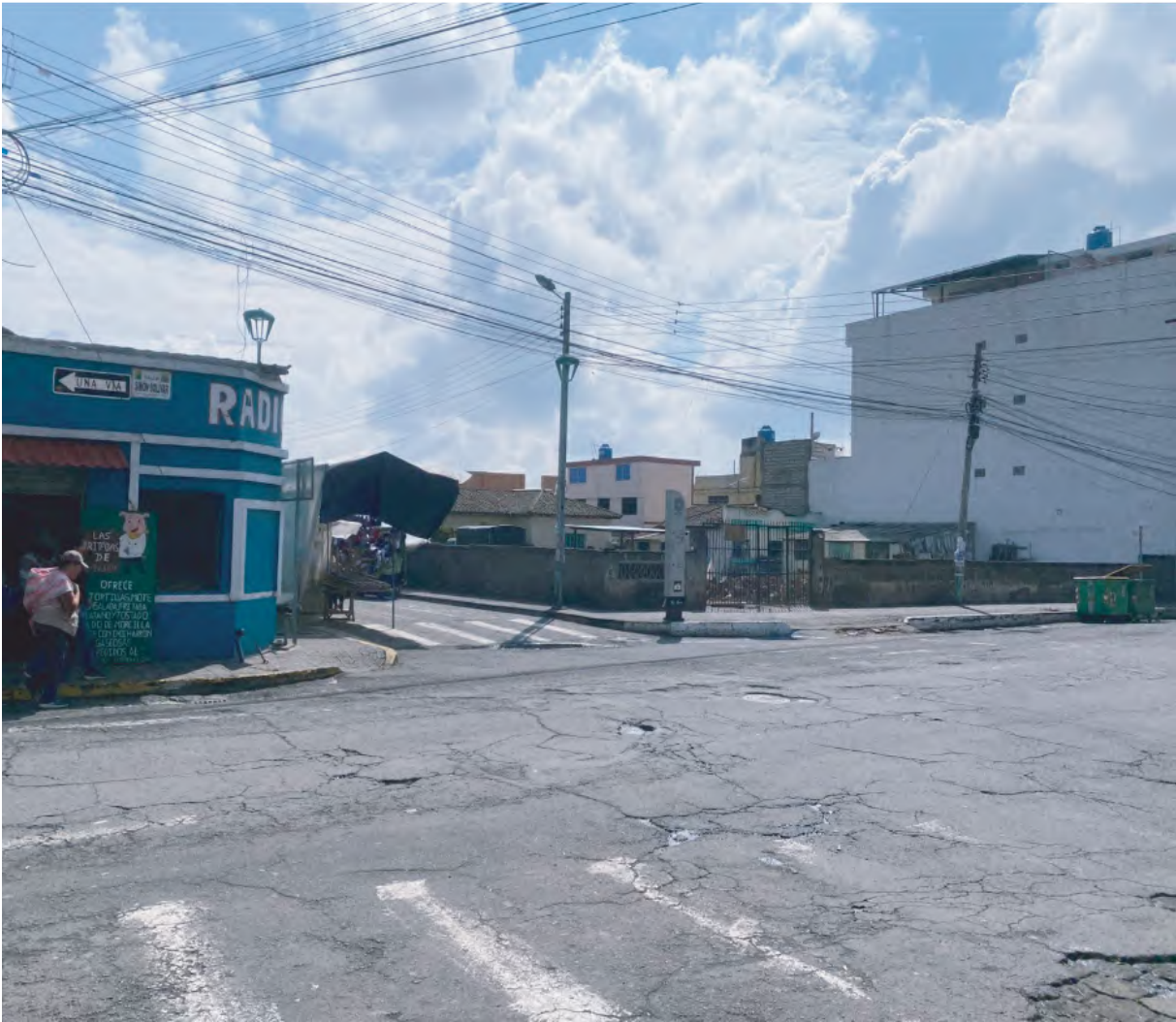
Figura 45. Vía Saquisilí, tramo dos, en mal estado - Antes
