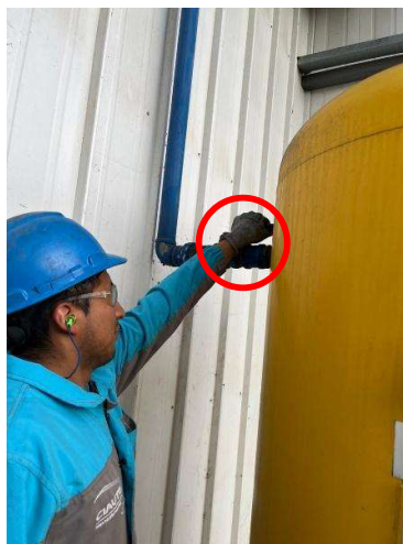
Imagen 1. Alimentación de aire a la planta de soldadura. Elaborado por: Molina, Williams (2024).
