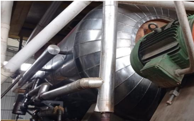
Digestor de Energía Térmica
