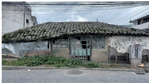
Figura 8. Vivienda abandonada en deterioro
