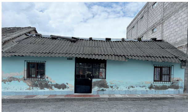
Figura 107. Vivienda con intervenciones inadecuadas
