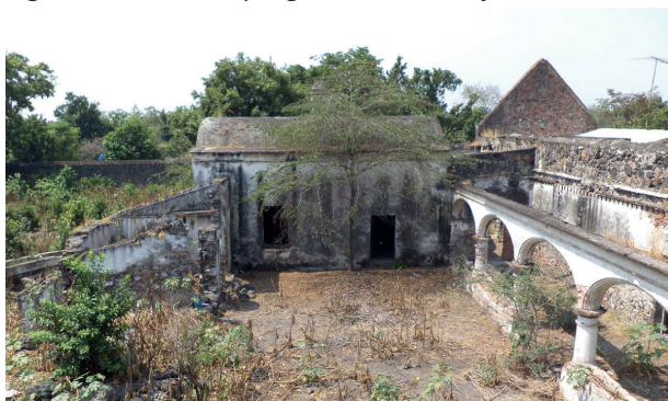
Figura 3. Deterioro progresivo en el Bajío mexicano
