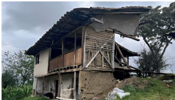
Figura 7. Deterioro de viviendas en Nulti
