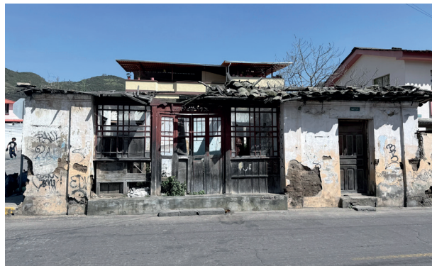
Figura 104. Vivienda en avanzado deterioro
