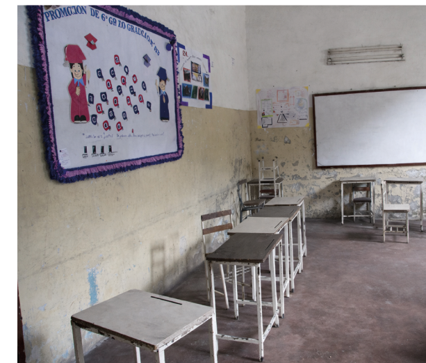
Figura 12. Instituciones en mal estado
