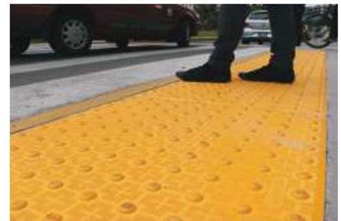
Asfalto para no videntes
