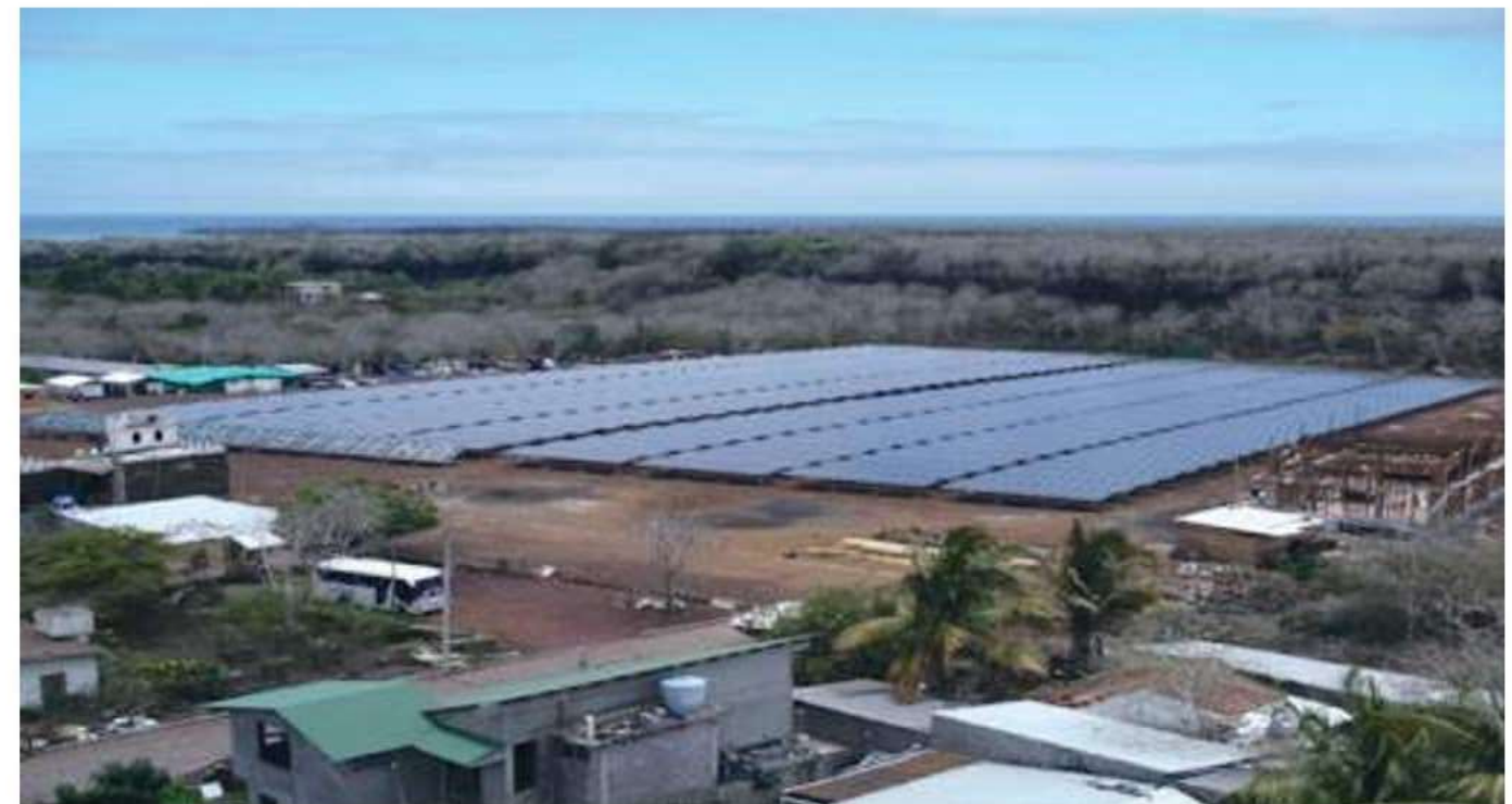
Proyecto fotovoltaico en Santa Cruz. (2014)
