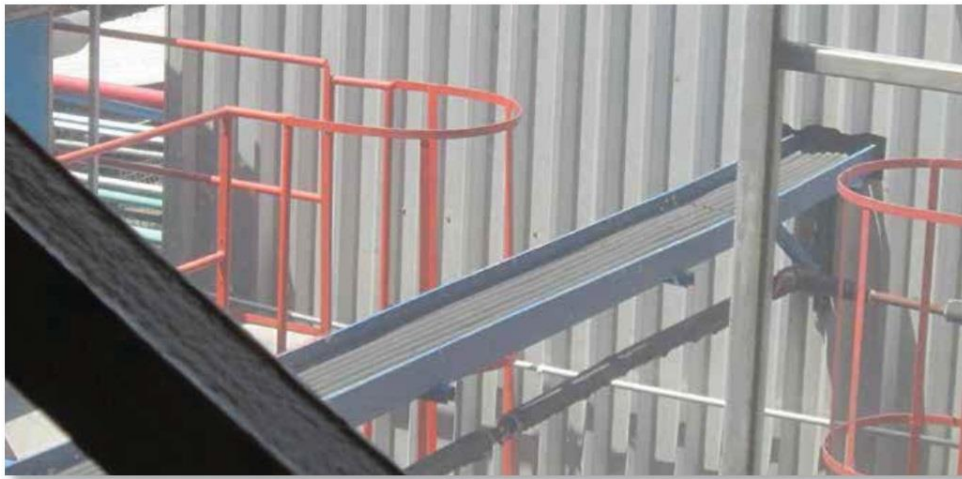
SUPERFLEX instalado en bandejas.
