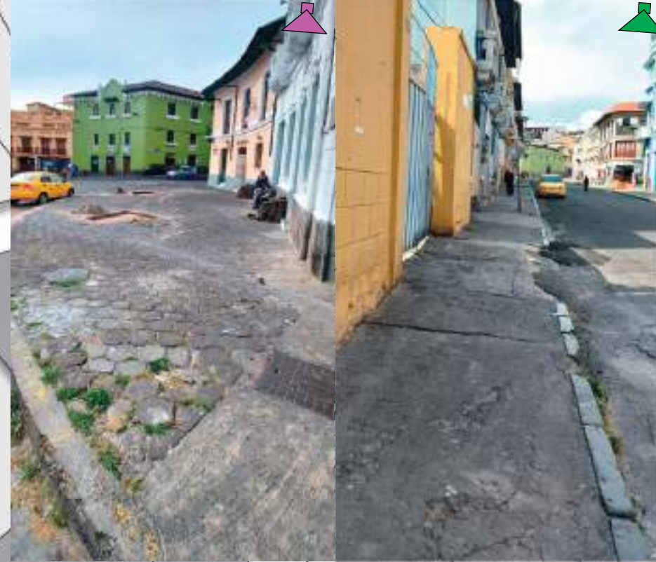
ESTADO DE ACERAS PLAZA VICTORIA Y AV IMBABURA
