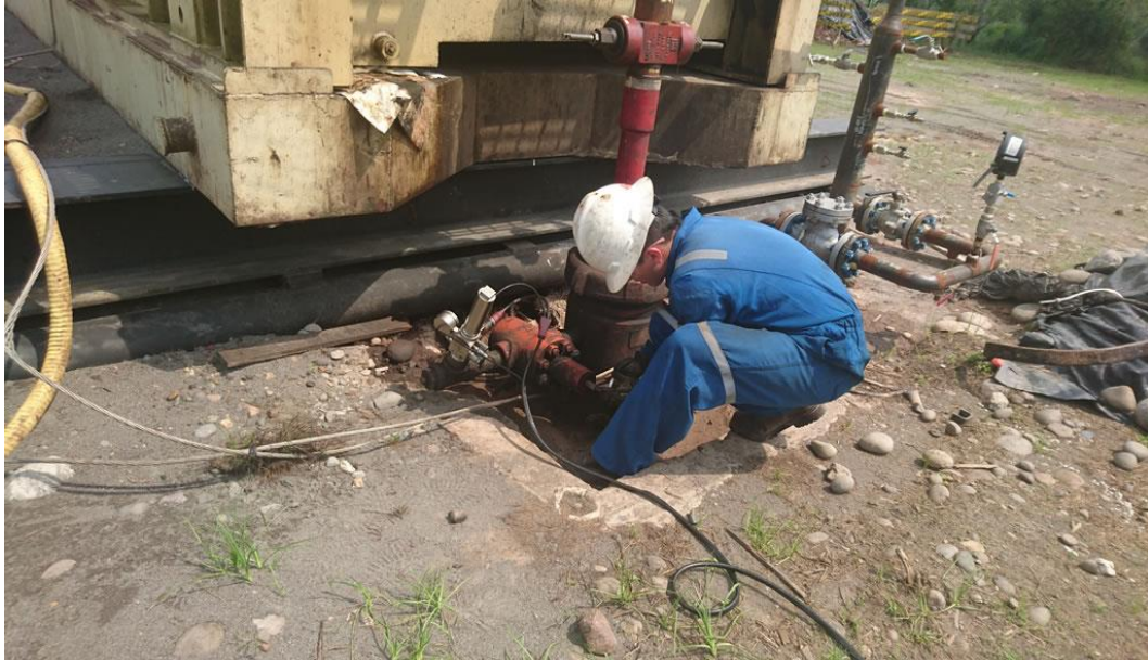
Toma de nivel de fluido de bombeo mecánico
