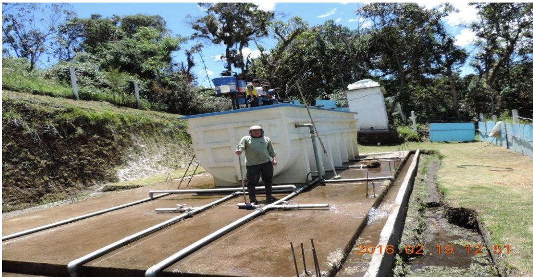
Figura 30: Operador de la planta de tratamiento de La Moca en pleno mantenimiento
