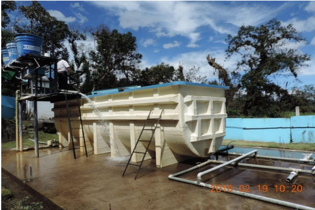
Figura 29: Planta de tratamiento de “La Moca” en pleno mantenimiento por parte del personal técnico de la Empresa Tecnohidro.
