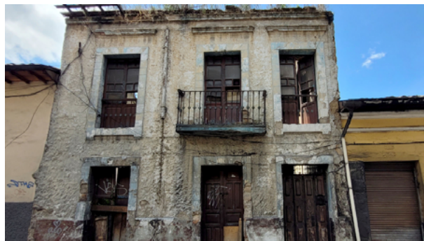
Figura 12. Casa en mal estado Centro Histórico de Quito.
