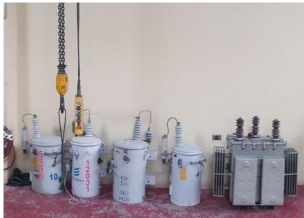
Imagen 6. Área de almacenaje de transformadores
