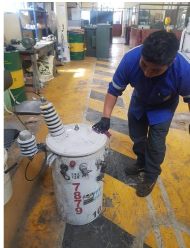
Imagen 5. Área de lavado y pintura de transformadores Fuente: Flores, Ángel (2023)
