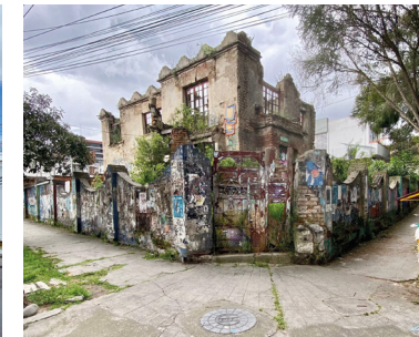
F2. Casa 1000 Inmueble patrimonial de la zona, funciona como punto de encuentro y expresión en el barrio. Se encuentra deteriorado.
