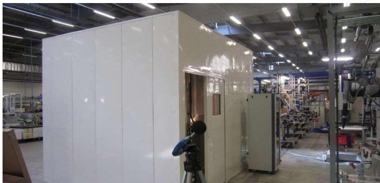
Imagen 2 - Cabinas de aislamiento acústico.
