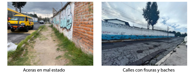
Figura 43. Aceras y calles en mal estado
