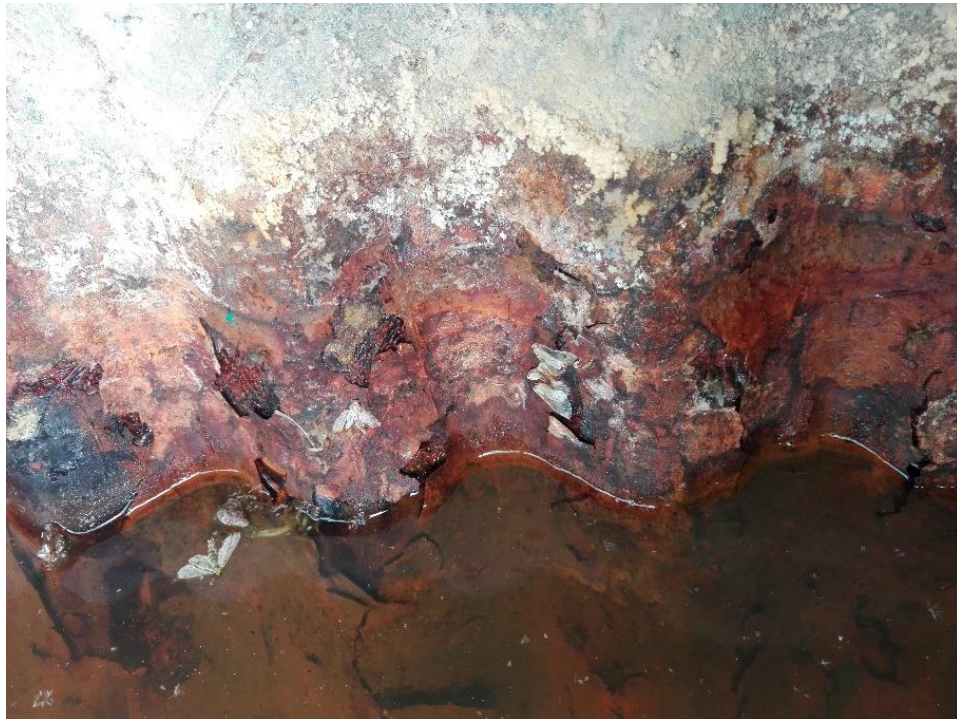
Figura 19: Deterioro actual de los tanques de preservado
