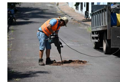
Figura 33. Vías de la zona urbana en deterioro y malas condiciones
