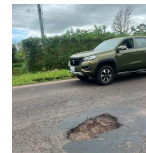
Figura 34. Vías de la zona rural en deterioro y malas condiciones
