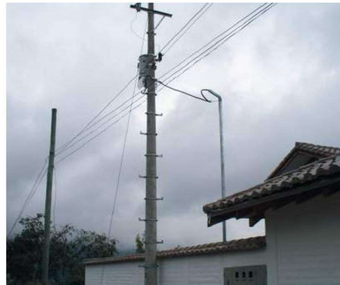
Conexión a la Red Pública de Energía Eléctrica (2008)
