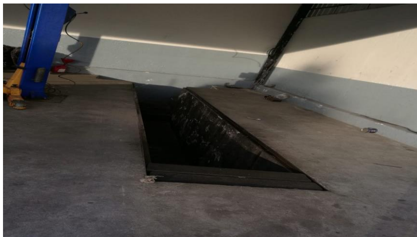
Figura 24: Área del taller sin marcaciones de seguridad
