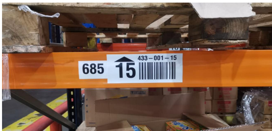
Figura No. 38. Check digitador instalado en las ubicaciones del almacén.
