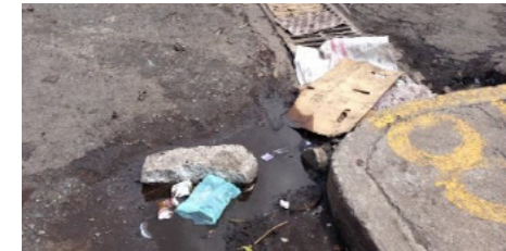
Figura 51. Aguas residuales/ malos olores
