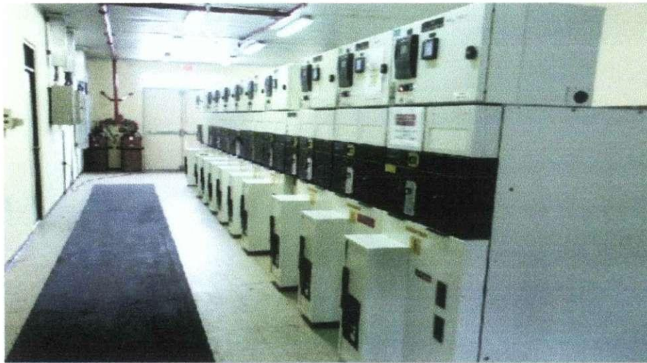
Figura 3: Interior de un MCC a 13800 Voltios Instalado en un wellpad de producción de Petroamazonas en el Bloque Palo Azul.
