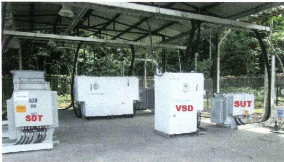
Figura 2: Shelter de equipos de superficie conectados a 480 voltios. Fuente: Petroamazonas
