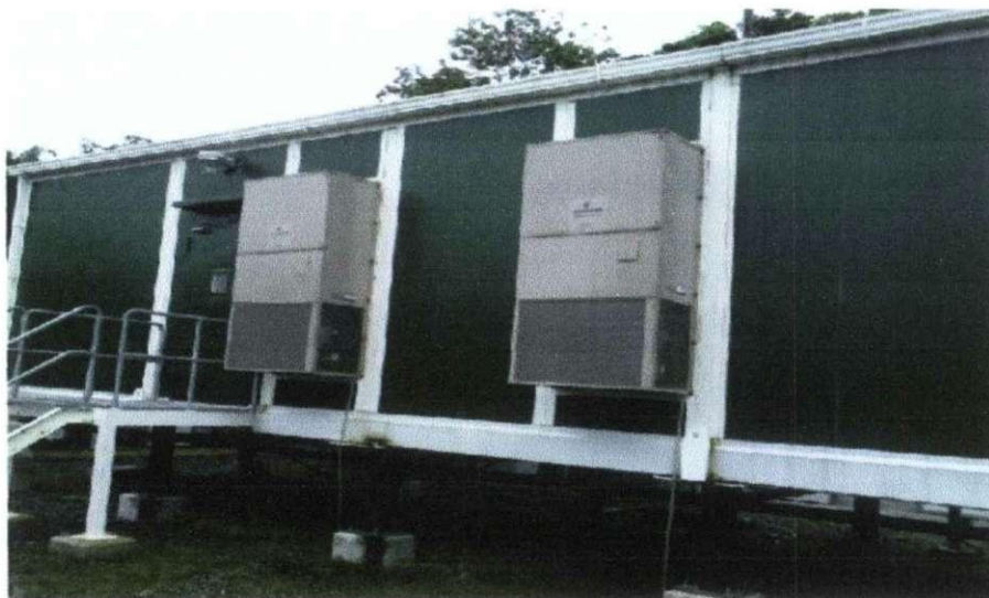
Figura 4: Exterior de un MCC a 13800 voltios instalado en un wellpad de producción del Bloque Palo Azul de Petroamazonas.
