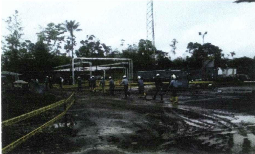
Figura 5: Trabajos de construcción de las facilidades de producción en un wellpad del Bloque Palo Azul de Petroamazonas.
