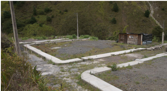
Figura 134. Lotización Viviendas de Interés Social en estado de abandono
