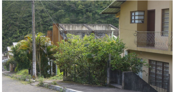
Figura 135. Viviendas de Interés Social afectadas por los aluviones
