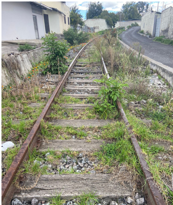
Nota: Deterioro de los durmientes de la vía férrea
