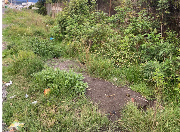
Nota: Evidencia del deterioro del espacio público y la vía férrea
