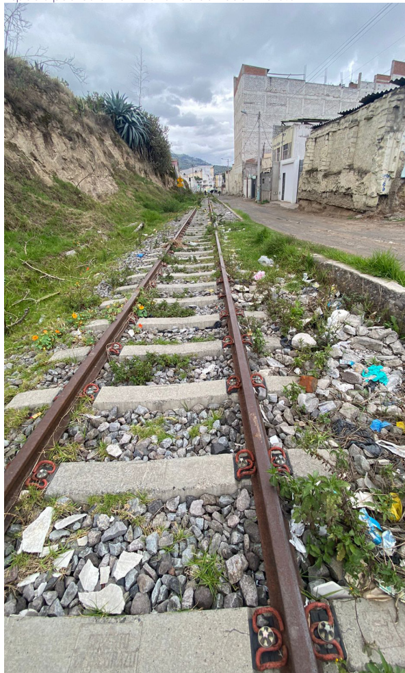
Nota: Estado actual de la línea férrea en la parroquia celiano monge
