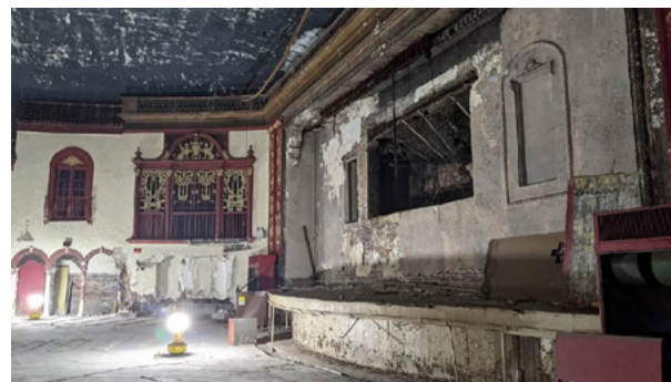
Figura 33. Interior del cine en deterioro
