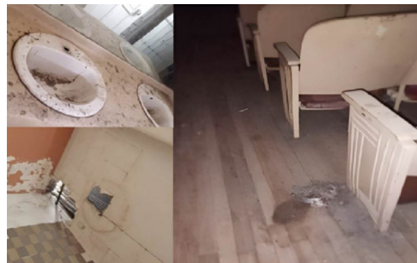
Figura 7. Cines en deterioro en Ambato.
