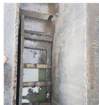
Recolección de aguas residuales en la última etapa trampas de grasa
