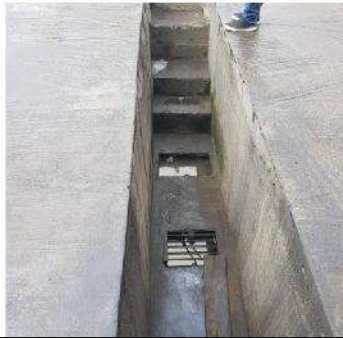
Trampas de grasa, de lavadora sector urbano Ambato
