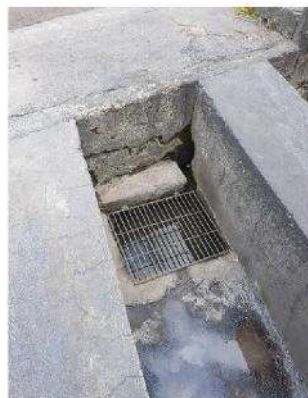
Trampa de grasa deteriorada
