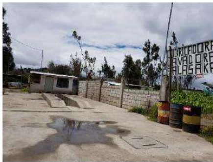
Mal diseño y construcción de la infraestructura
