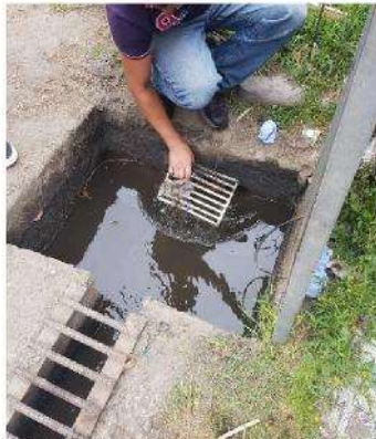
Trampa de grasa mal ubicada
