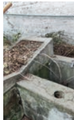
FOTOGRAFÍA 18 Lavandería llena de maleza y deterioro de la piedra para lavar.
