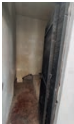
FOTOGRAFÍA 26 Deterioro del piso de la pequeña celda.
