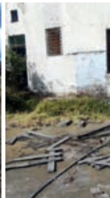
FOTOGRAFÍA 15 Deterioro paredes, crecimiento de maleza ya apropiándose a la edificación.
