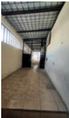
FOTOGRAFÍA 1 Deterioro de paredes, puertas y techos.
