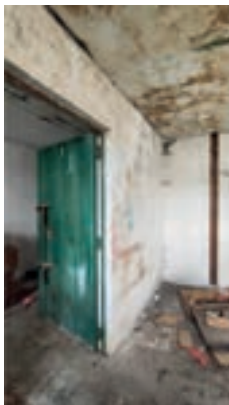
FOTOGRAFÍA 19 Deterioro de paredes y del piso, lleno de basura.
