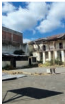
FOTOGRAFÍA 11 El patio se ha llenado de basura y el deterioro de diferentes elementos exteriores.
