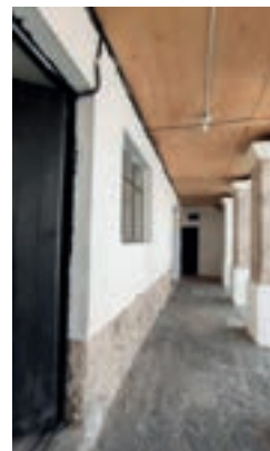
FOTOGRAFÍA 24 Deterioro del techo y espacios donde eran celdas.
