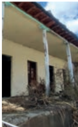
FOTOGRAFÍA 14 Deterioro del techo de la casa, apropiación de la naturaleza con respecto a las gradas y estructura de la casa.
