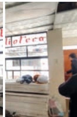
FOTOGRAFÍA 6 El espacio esta lleno de los paneles de metal del techo que ya no valen.
