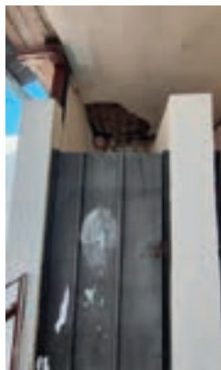
FOTOGRAFÍA 28 Deterioro de techo y paredes de la parte de los baños de la planta superior de la edificación.
