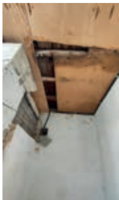
FOTOGRAFÍA 22 Deterioro del techo como también de paredes.
