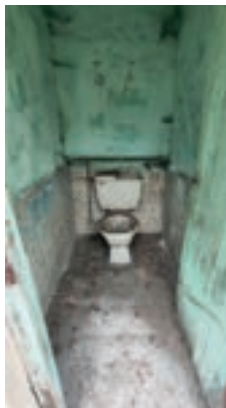
FOTOGRAFÍA 16 Elementos sanitarios rotos y sucios.
