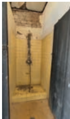
FOTOGRAFÍA 29 Deterioro de la baldosa del baño y como también de la tubería de agua.
