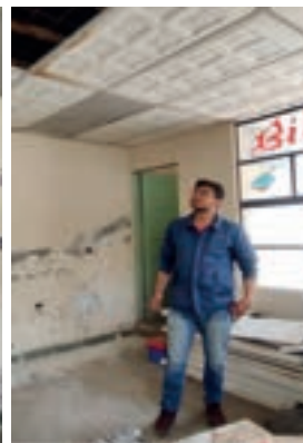
FOTOGRAFÍA 5 Deterioro de paredes por la humedad y deterioro del piso.
