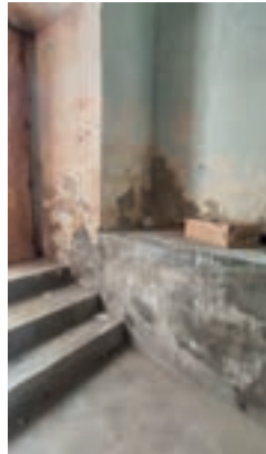
FOTOGRAFÍA 31 Deterioro de paredes y muros.
