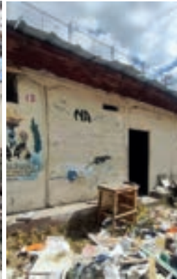
FOTOGRAFÍA 8 Las paredes de las celdas están llenas de dibujos y dentro de ellas ropa y diferentes cosas que pertenecían a los ppl.
