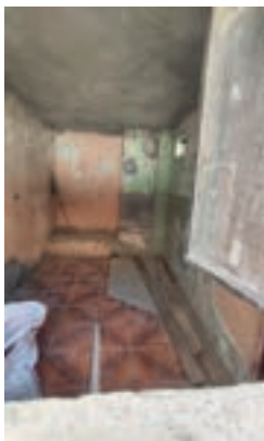
FOTOGRAFÍA 25 Deterioro de paredes, techo y piso de la celda.
