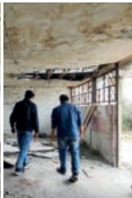
FOTOGRAFÍA 20 Deterioro del techo, escombros caídos en el piso.
