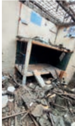
FOTOGRAFÍA 7 Las celdas están llenas de basura y sobre todo ya no existe la estructura del techo.
