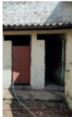
FOTOGRAFÍA 17 Deterioro de la baldosa y puertas de madera.
