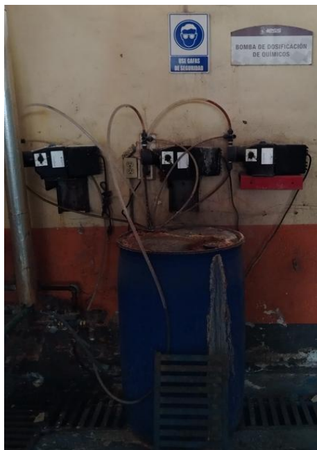
Imagen 7. Sistema de dosificación de químicos Elaborado por: Santamaria, J (2025).
