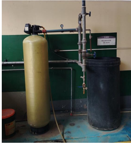
Imagen 6. Tanque de tratamiento de agua Elaborado por: Santamaria, J (2025).
