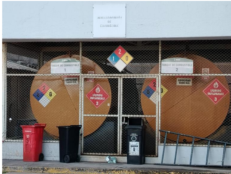
Imagen 10. Tanques de combustible Elaborado por: Santamaria, J (2025).
