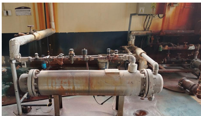
Imagen 9. Sistema de recirculación de agua Elaborado por: Santamaria, J (2025).
