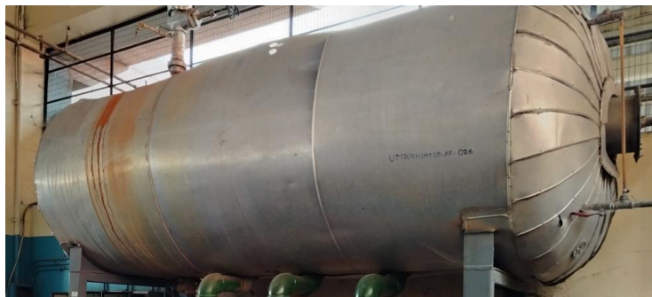
Imagen 8. Tanque de condensado Elaborado por: Santamaria, J (2025).
