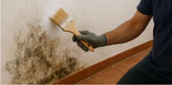
Figura 13 Manchas de humedad
