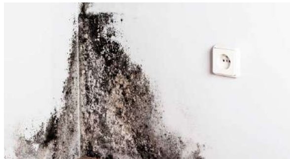
Figura 9 Moho en las paredes
