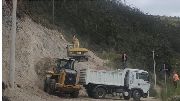
Imagen 4-5: Trabajador sobre cabina de volqueta sin protección contra caídas.
