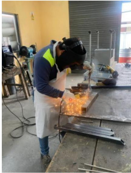
Imagen 4-11: Soldadura con cables en piso e instalación improvisada.
