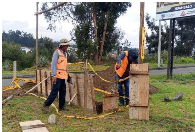
Imagen 4-10: Trabajo en zanja con entibación insuficiente.
