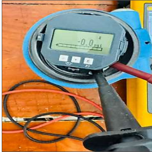
Figura 7. Puesta a cero al transmisor de presión.
