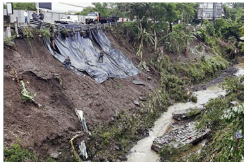
Imagen 1. La carretera, a la altura de la comunidad La Cuchilla, en Antigua Cuscatlán, sufrió un hundimiento Fuente: Revista La Prensa Paz (2020)
