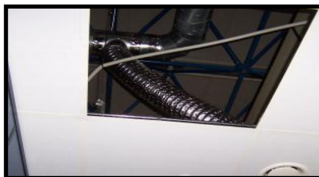
Figura N° 20: Campana de extracción de gases
