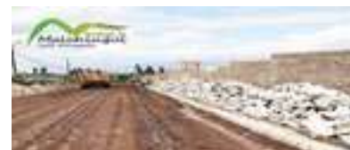
Infraestructura vial rural en mal estado
