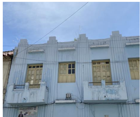
humedad de paredes en fachada
