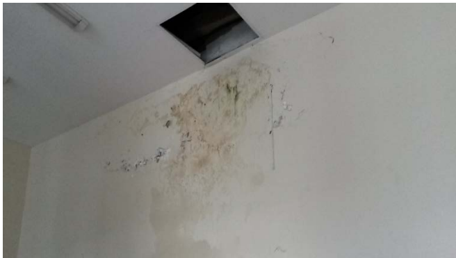
10.Descripción: Evidencia de problemas de humedad. Fuente: El autor
